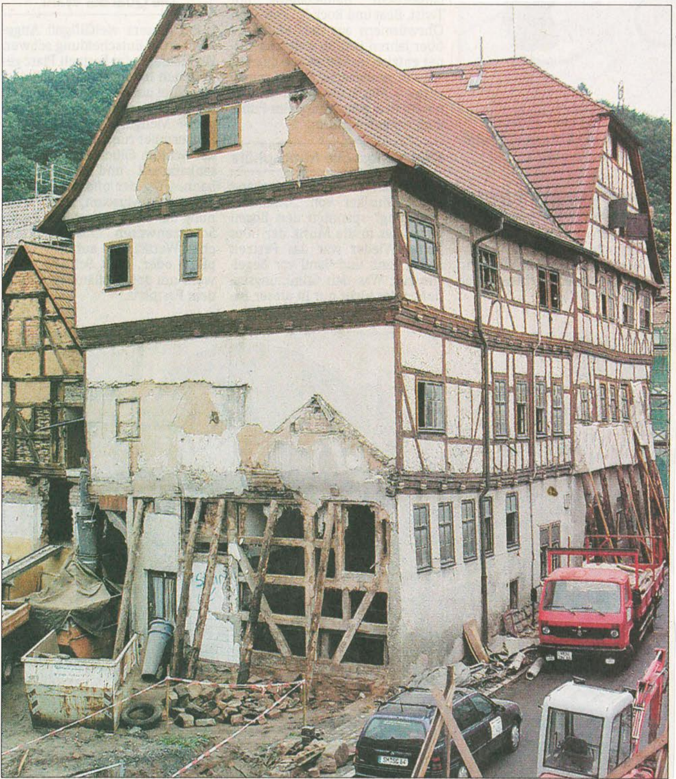
Das Wasunger Rathaus, die Baustelle Nummer 1 in der Fachwerkstadt, stand zur jüngsten Bau- ausschusssitzung wieder im Mittelpunkt der Tagung. dFoto: J. Glocke
